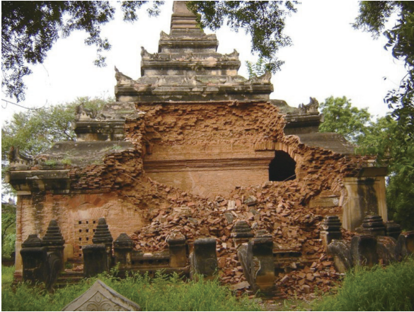
図13 大雨の被害（バガン遺跡）
