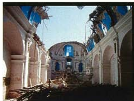
写真2 2007年ペルー・リマでの地震
