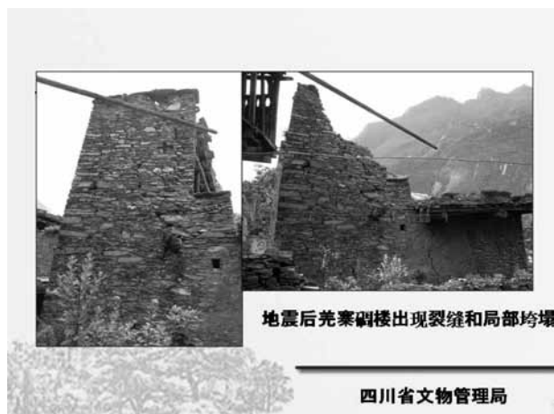
写真 12 被災した桃坪羌寨の碉楼 (東京文化財研究所編 2009 より引用)
