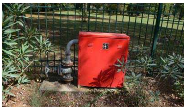
図 4-48 遺跡内の消火栓
