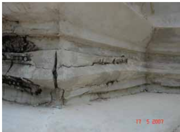
写真 4-2-6 : 東南角の基壇近くに入った亀裂 (図 4-6 の 3)
