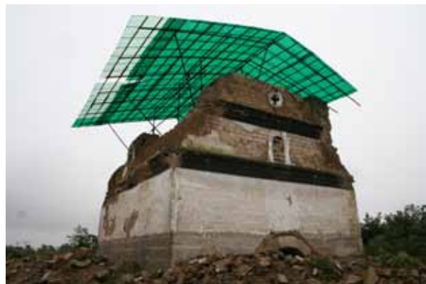
写真 10 被災した安県文星塔
