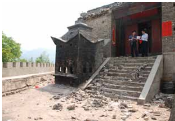
写真5 陝西省西郷午子観における屋根瓦の崩落 (趙強撮影、写真提供：陝西省文物局)
