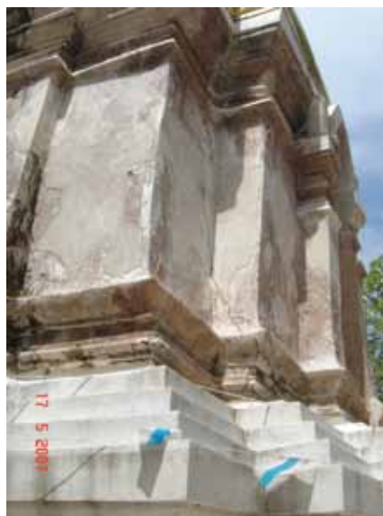
写真 4-2-9 : 漆喰に入った亀裂
