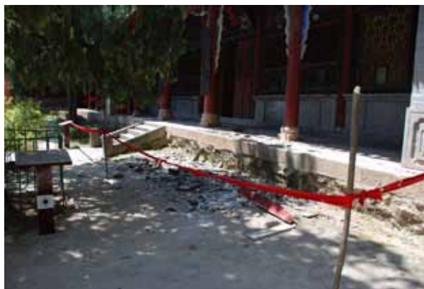
写真6 陝西省留バイ県張良廟五雲楼建築の被災状況 (趙強撮影、写真提供：陝西省文物局)
