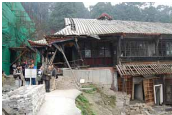
写真8 被災した二王廟の一部
