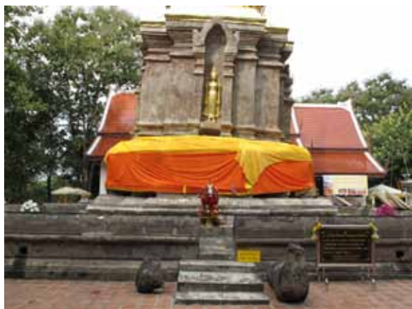
写真 4-1-2 : パゴダ南面。水平を確認して撮影。東側に大きく傾斜しているのがわかる。
