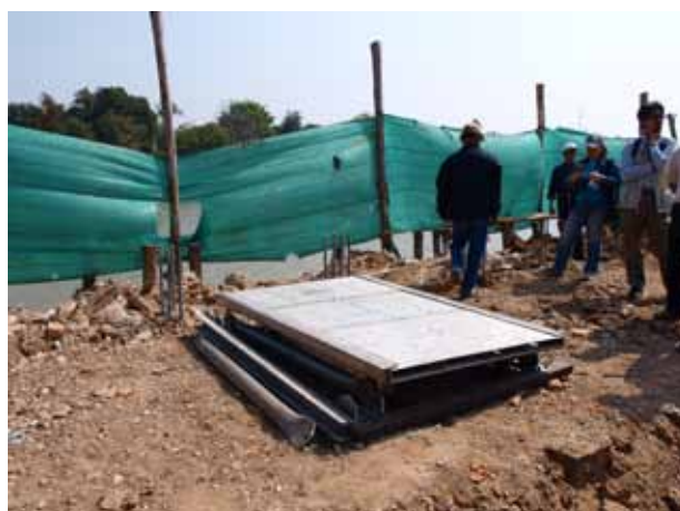
写真 2-3-5: ワット・チャイワタナラム。盾状の浸水防止設備。可動式で、また平常時にはたたんでおくことが可能である。
