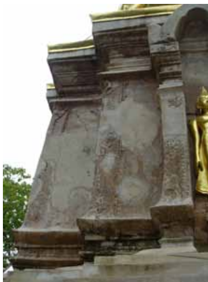
写真 4-2-5：地震によるパゴダ壁面 (東南角) の亀裂 (図 4-6 の 2)
