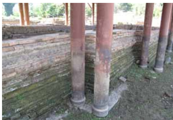
写真 2-2-2 : Ku Pa Dom, ウィアン・クム・カーム遺跡。雨季が終わって間もないため、土が湿ってぬかるんでいる。浸水する部分まで覆屋の柱が変色し、煉瓦の遺構に藻類が繁茂するとともに、浸水部分の境界付近で白華が観察される。
