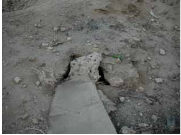
図 35. 地表に剥き出しとなった石室
