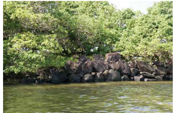
写真 39 外洋側人口島の石垣と植物繁茂
