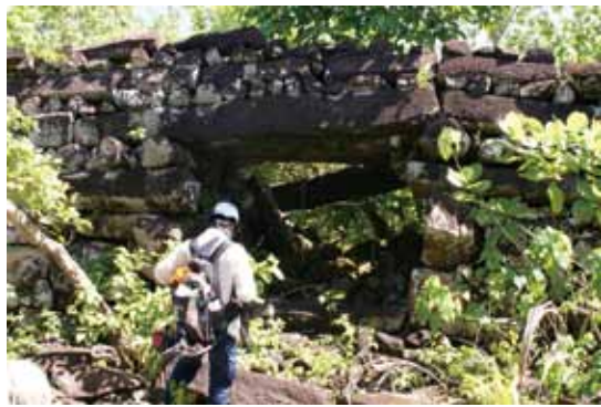
写真 21 墓周壁入口の天井石の崩落
