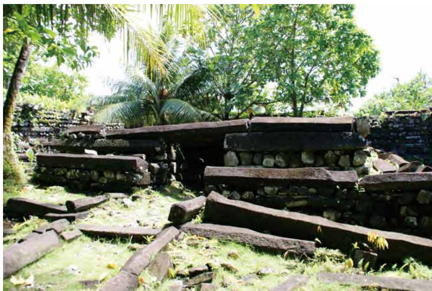
写真 19 中央石室開口部周辺の柱状玄武岩の崩落
