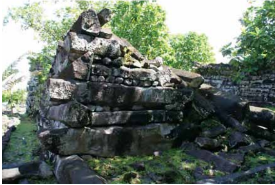
写真 15 入り口北側周壁の崩落
