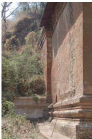
図 16. チャウクーウーミン東面外壁の孕み出し状況
