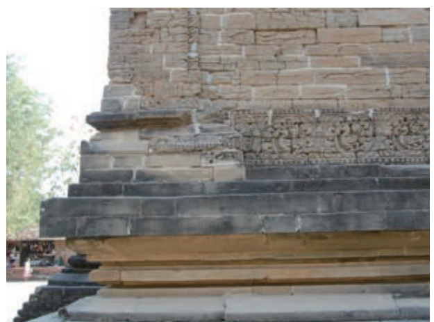
図 28. ナンパヤーの劣化した当初砂岩材(上方)と新材置換部分(下方)
