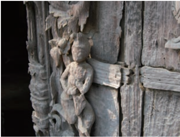
図 58. シュエナンドー僧院外壁面の劣化状況
