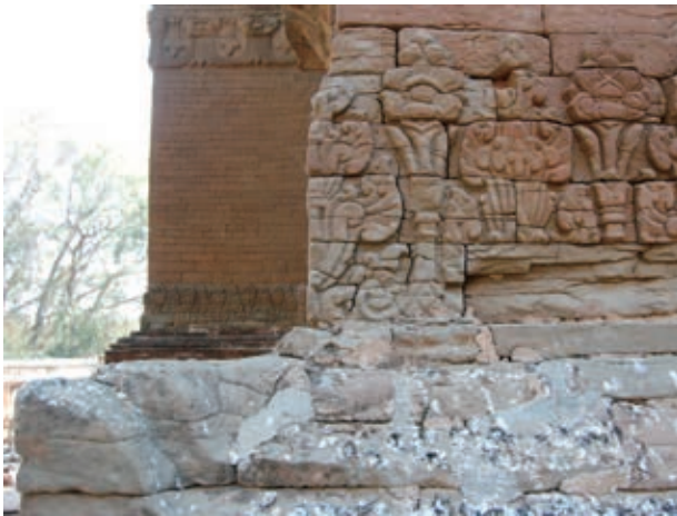
図 14. チャウクーウーミン外壁基部砂岩の劣化状況
