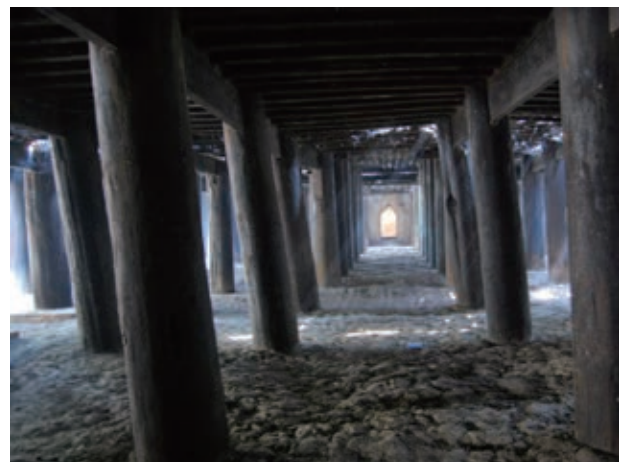
図 79. バガヤ僧院の床下部における柱の傾斜と土砂の堆積
