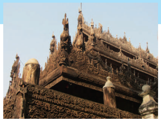
▲ 風化が進むマンダレーの木造建造物
