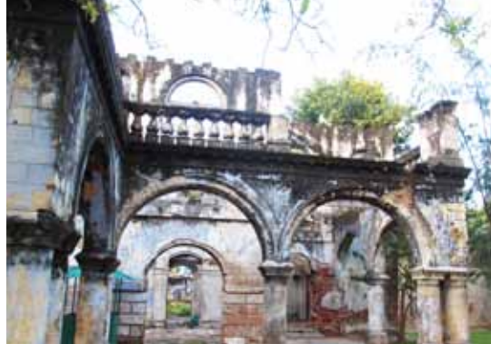
内戦によって被害を受けた旧市庁舎
