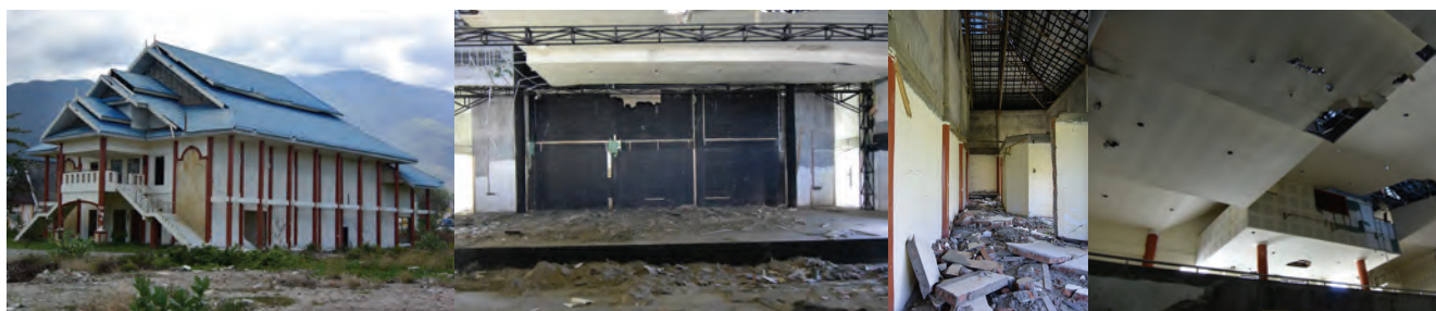
図 5 被災した文化センター 内部のオーディトリウムは破壊され、再建の目途はたっていない。
