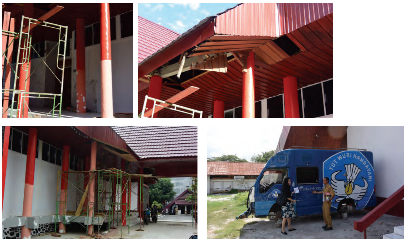
図 33 中部スラウェシ博物館の被害 被災した移動巡回車
