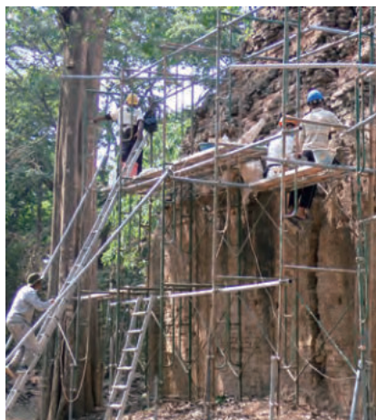
煉瓦造遺構の修復工事現場（オンジョブ形式でのトレーニング）
