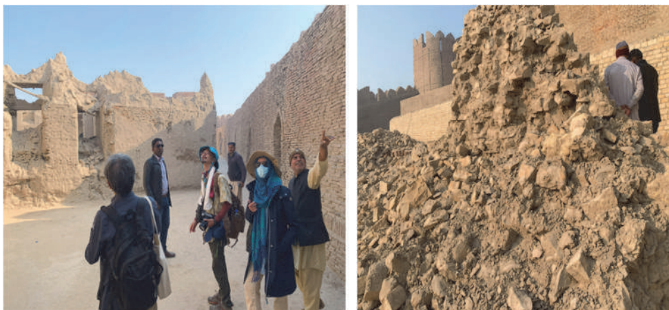
図 73 被害後の壁や構造物の状況。
