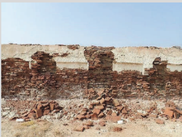
図 93 北壁の南面では部分的にレンガ積みの崩落が認められる。
