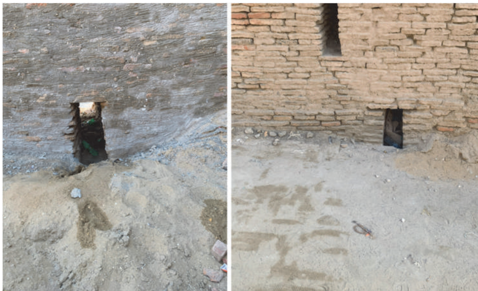
図 76 排水システムの現状。
