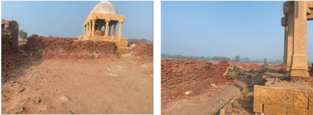
図 98 被災後の壁や構造物の状況。
