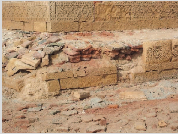
図 101 基壇はレンガ積みであることが崩落している部分からわかる。
