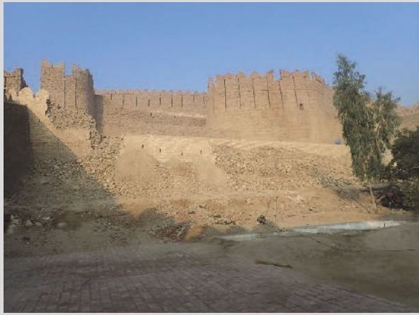
図 77 2022 年洪水による城壁の崩落部分。
