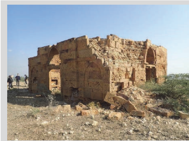
図 118 石積みを主とする建造物。2022 年洪水の時の強い降雨で建物が崩落している。
