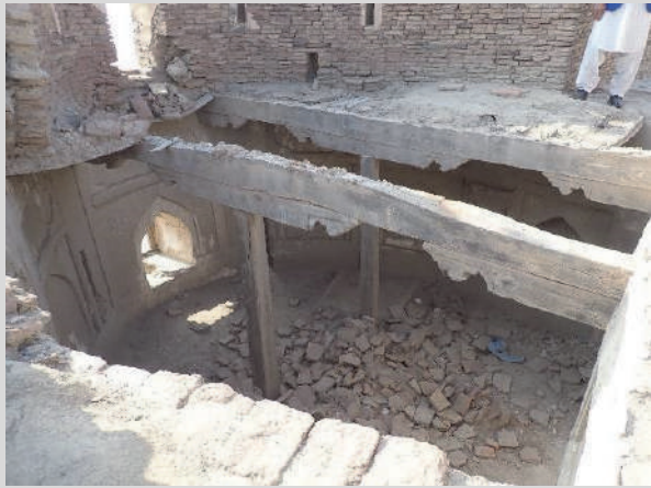
図 81 屋根が崩落した浴場。
