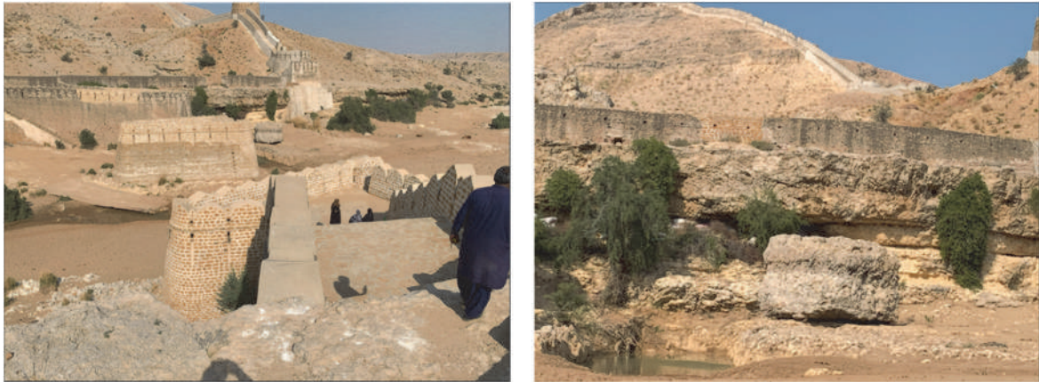
図 109 正門付近のサン川の流路と、砂袋で支えられた壁基礎の浸食状況。
