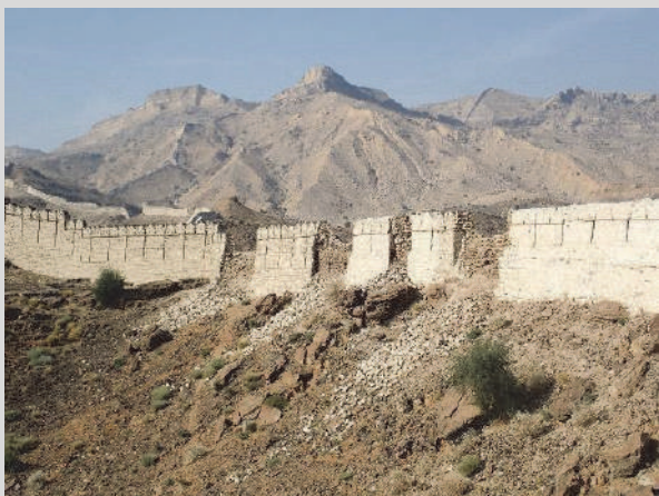
図 112 城壁の崩落状況。崩落した部分からは白色の石灰岩が散在しており、修復した部分であることがわかる。
