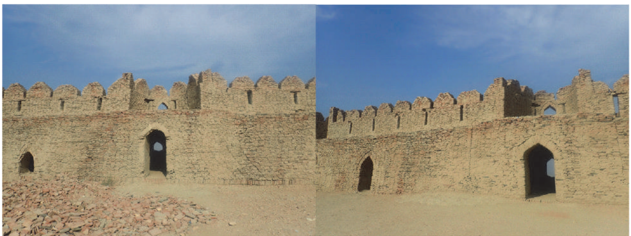
図 42 対象建物 (コートディジー城) (左: 西側-損傷大 | 右: 東側-損傷小)。
