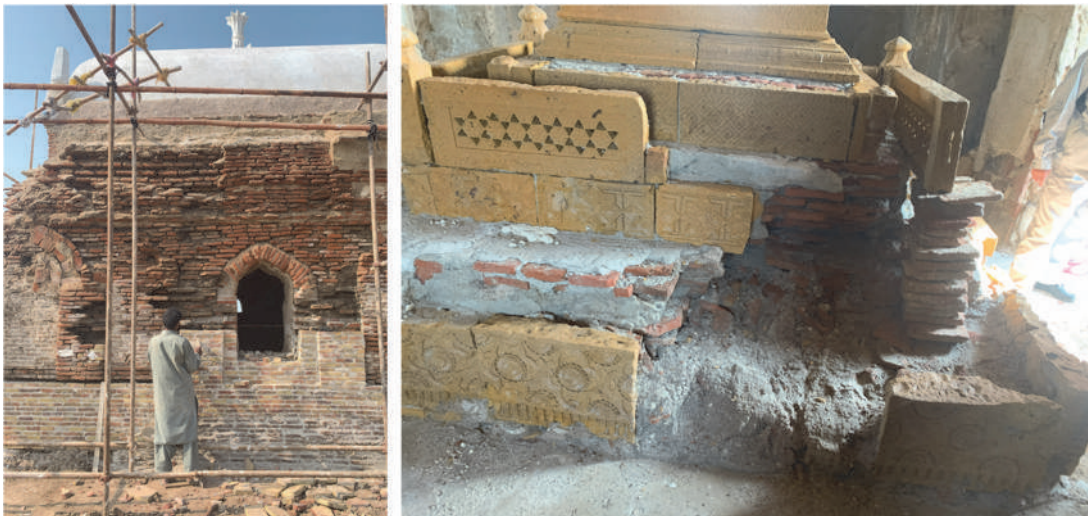
図 99 外壁の改修や修復工事、湿気による墓の構造物の損害。
