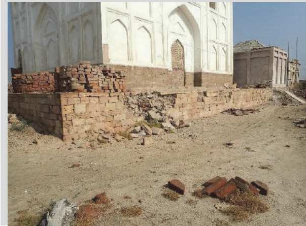
図 87 石灰岩ブロックで化粧したレンガ積み基壇上に建てられている廟。基壇は一部崩落している。
