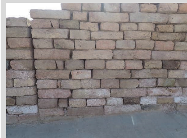
図 68 北面の壁の塩類風化の状況。下から 5 段目より下で塩類の析出が認められる。
