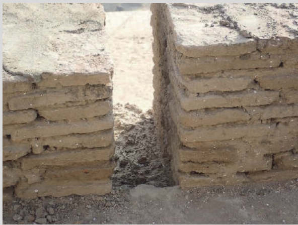
図 78 銃眼の部分。この部分から水が流出したことで排水の機能がある程度果たしたが、同時に損傷を受けている。
