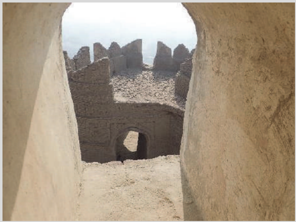
図 82 図の奥の方の屋根部分の漆喰層が断片化し、防水機能を失っている。
