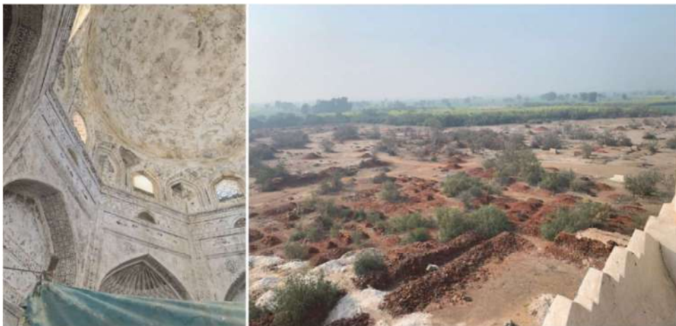
図 85 メインドームに亀裂が入り、周囲の墓に損害が見られる。
