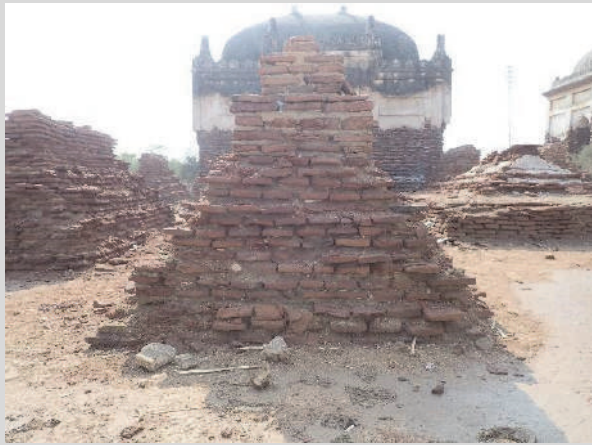
図 95 レンガ積みの墓。北面の状態は東面、南面、西面に比較して劣化は大きくない。
